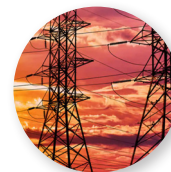
Testowanie sieci elektrycznych
